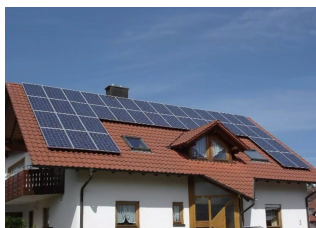
太阳能光伏板
