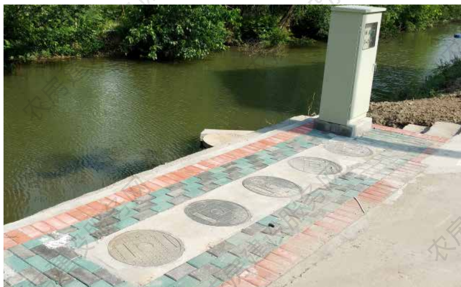
净化槽技术应用实例
