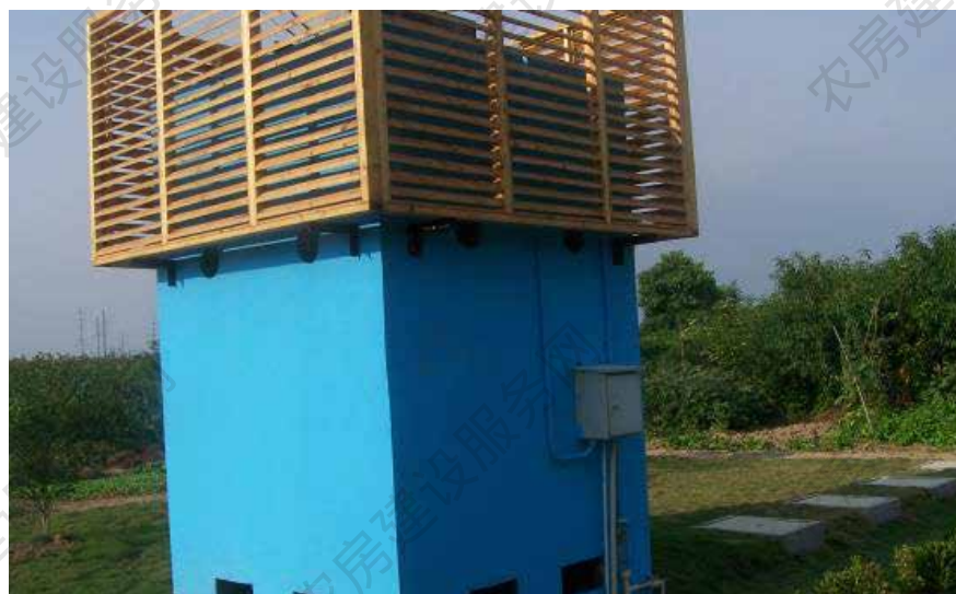
脉冲生物滤池 - 人工湿地技术应用实例
