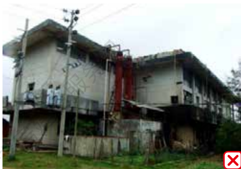
建筑体量过大
